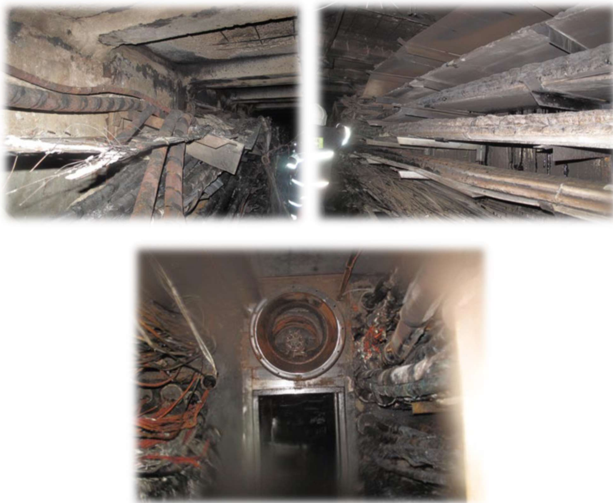
Рисунок 3.3 – Фрагменты обстановки на месте работ после тушения пожара в коллекторе по адресу г. Москва, Ленинградский проспект, д. 33А
